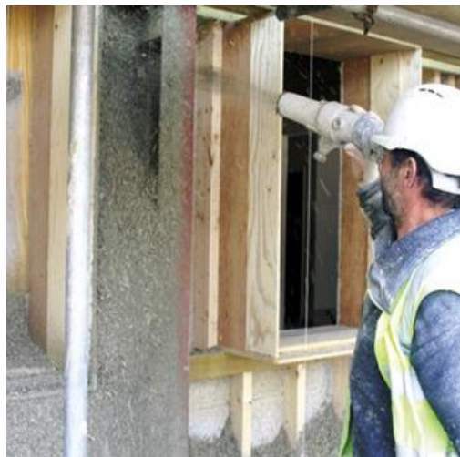
Fig. 3. Modul de punere în operă, prin pulverizare, a amestecului de materiale în vederea realizării stratului termoizolant pe pereți existenți
